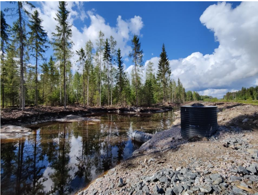
Kuva 19. Sätökaivo Konttisuon metsäisen viivytyskosteikon veden purkautumiskohdassa. Kuva on otettu kesäkuun alussa ennen kuin Salmelanojan vesiä on ohjattu alueelle. Alueella seisova vesi on pääosin metsäalueiden valumavettä (Elina Kajava, Ylivieskan kaupungin ympäristöpalvelut 2024).
